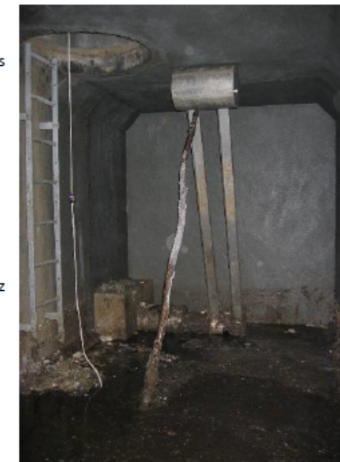
Détail de l'organe de régulation (vanne à flotteur) d'un ouvrage de stockage enterré.
