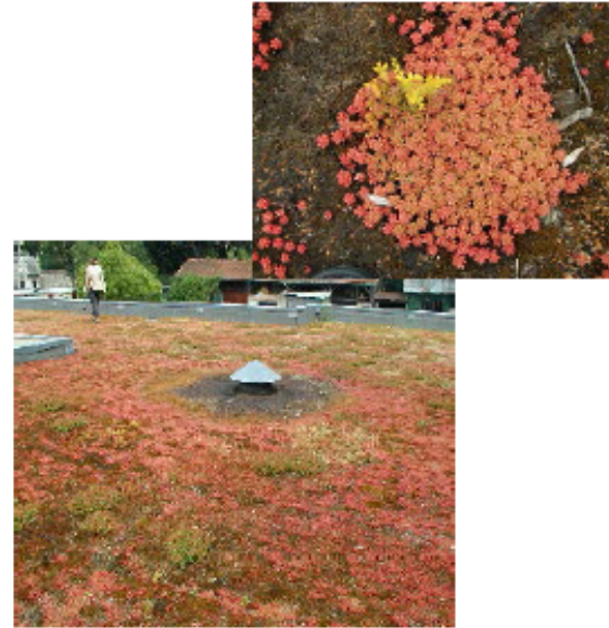
Toiture végétalisée extensive des locaux techniques de la DEVE au cimetière du Père-Lachaise à Paris 20 ème (photos DPA)
