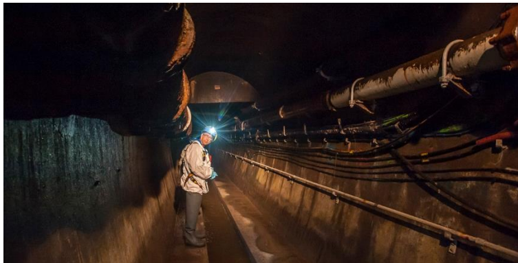
Photo 29. Les égouts à Paris (Ville de Paris)
