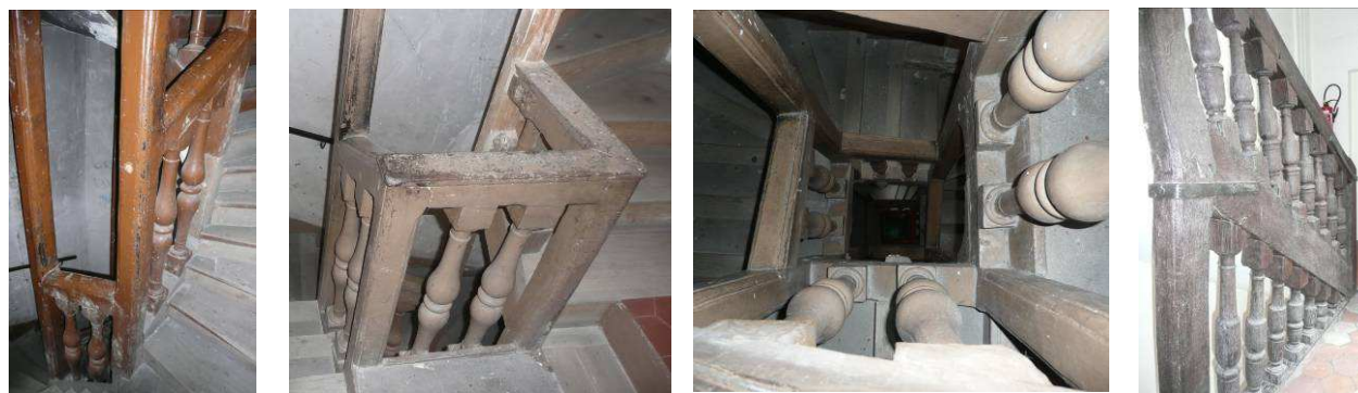
Exemples d'escaliers du XVII e siècle à quatre noyaux. 32 rue du Poitou
